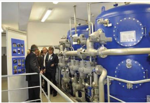
Wasser ist Leben: eröffnet wurde der Rundgang im Wasserwerk der Gemeinde Schwarzenbruck, das in Rummelsberg steht.
